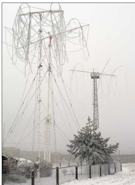
Wieder einmal schlugen die Unbilden des Winters in Illmenau bei DA0HQ hart zu: vereiste Elemente richteten an diversen Quadantennen (u.a. 3-Element-Quad für 40 m im Bild rechts) schwere Schäden an. Foto: H. Weissleder
